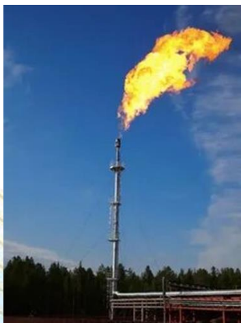
Рис. 1 – Высотная факельная установка открытого типа
